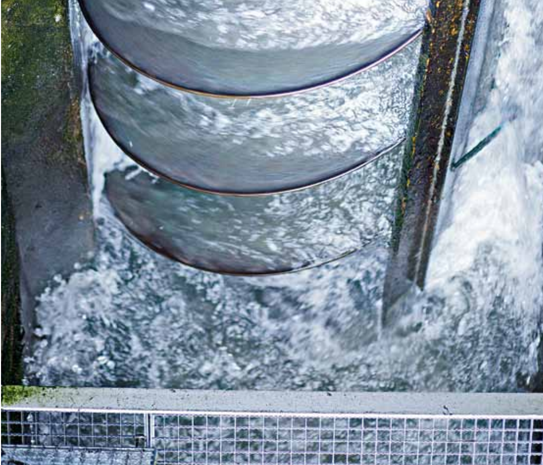
Eine Schneckenpumpe transportiert Schmutzwasser in der Zentralkläranlage in Extertal
