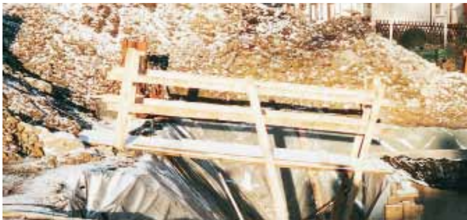
Achten Sie darauf, dass die Laufstege nicht vom Auflager abrutschen können.
