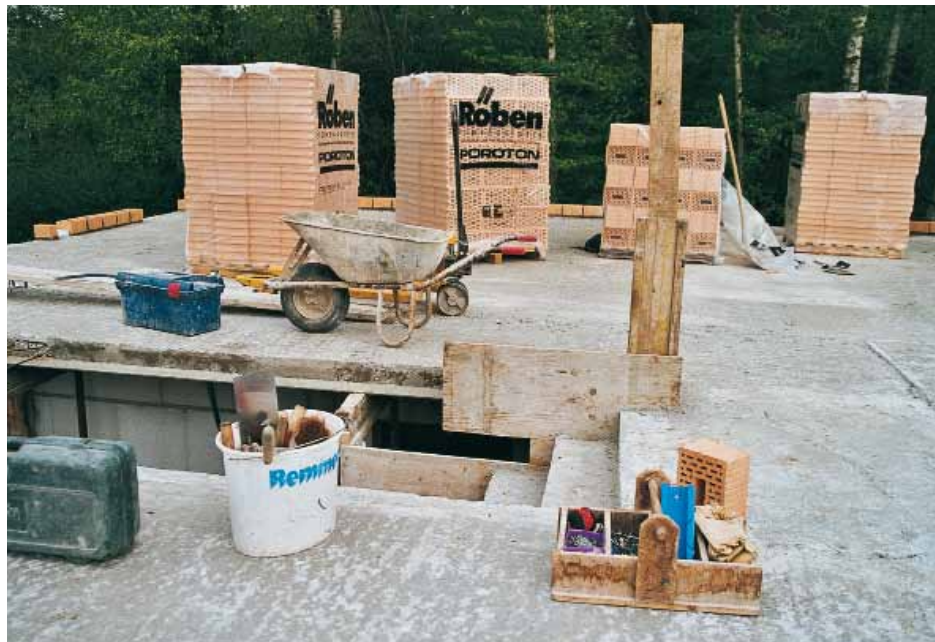
Hier ist Seitenschutz als Sicherungsmaßnahme an der Treppenöffnung erforderlich.
