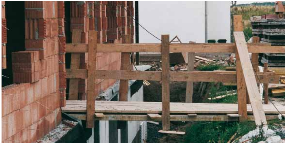
Bei mehr als 2,0 m Absturzhöhe müssen Laufstege mit einer Absturzsicherung – Geländer – versehen sein.
