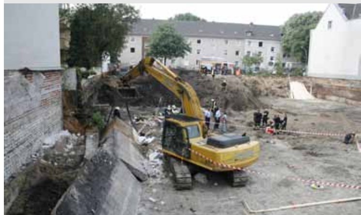
Unter der Mauer wurden zwei Arbeiter verschüttet. Mit dem Bagger und mehreren Lufthebekissen wurden die Männer befreit.
