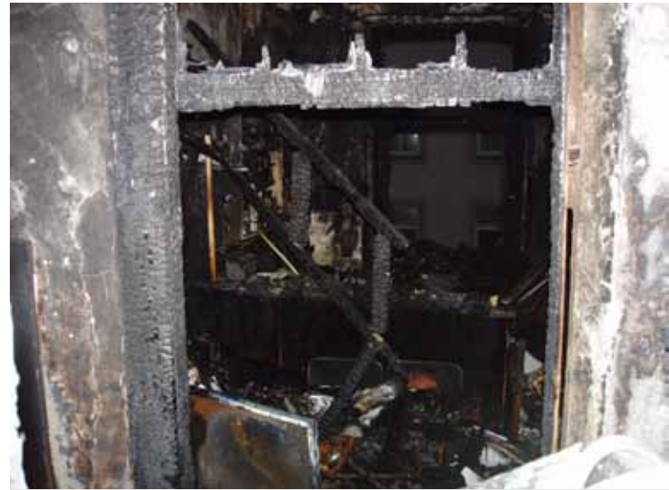
Blick in eine Wohnung, die durch Feuer völlig zerstört wurde.
