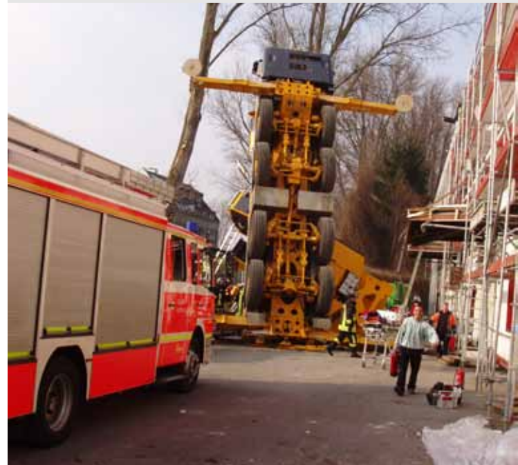
Kranunfall Harffstraße: Bei Baumfällarbeiten kippte ein Autokran um.
