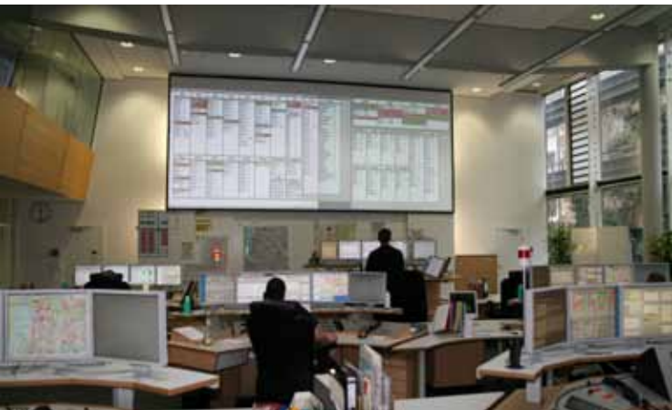
Leitstellenraum: Die Fahrzeugzustandsanzeige wird über Beamertechnik an die Wand projiziert.
