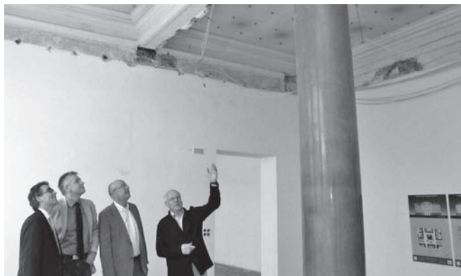
Oberbürgermeister Gregor Kathstede, Baudezernent Martin Linne, Kulturdezernent Roland Schiffer und Architekt Winfried Brenne (v.l.n.r.) beim Auftakt der Bauarbeiten im Kaiser-Wilhelm-Museum.
