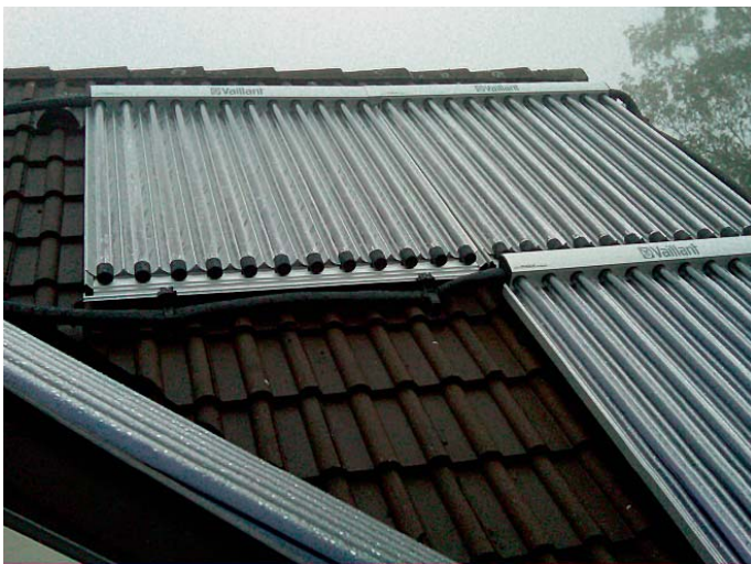
Fertige Solaranlage mit Röhrenkollektoren auf dem Dach des Kunden
