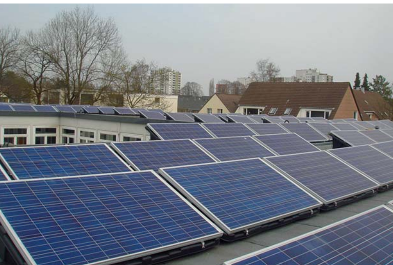
Photovoltaikanlage auf dem Röntgen-Gymnasium
