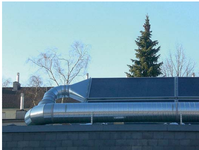
Luftkollektoren auf der Mehrzweckhalle der Grundschule Dörpfeld
