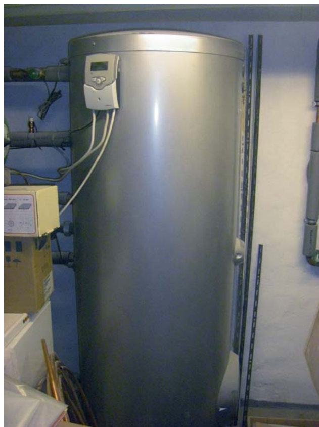
Solarspeicher – aufgestellt im Keller – mit 500-Liter Inhalt
