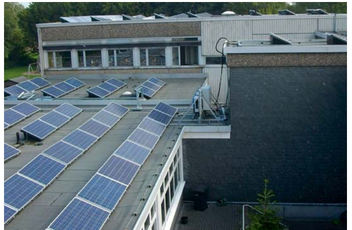
Photovoltaikanlage auf der Grundschule Hackenberg
