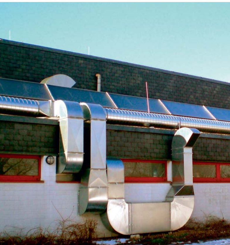
Luftkollektoren auf der Mehrzweckhalle der Grundschule Dörpfeld
