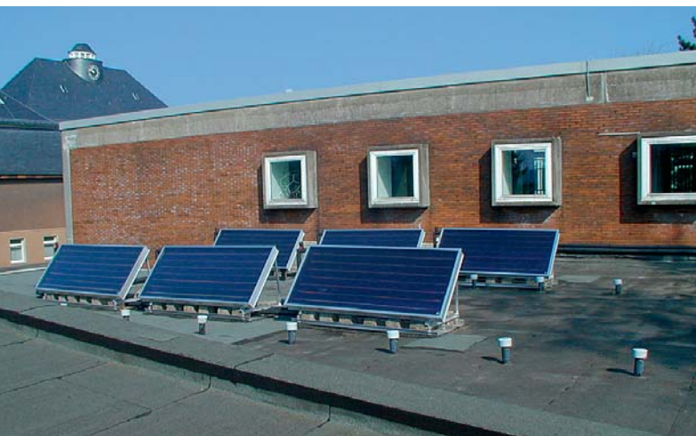
Thermische Solaranlage auf dem Röntgen-Gymnasium
