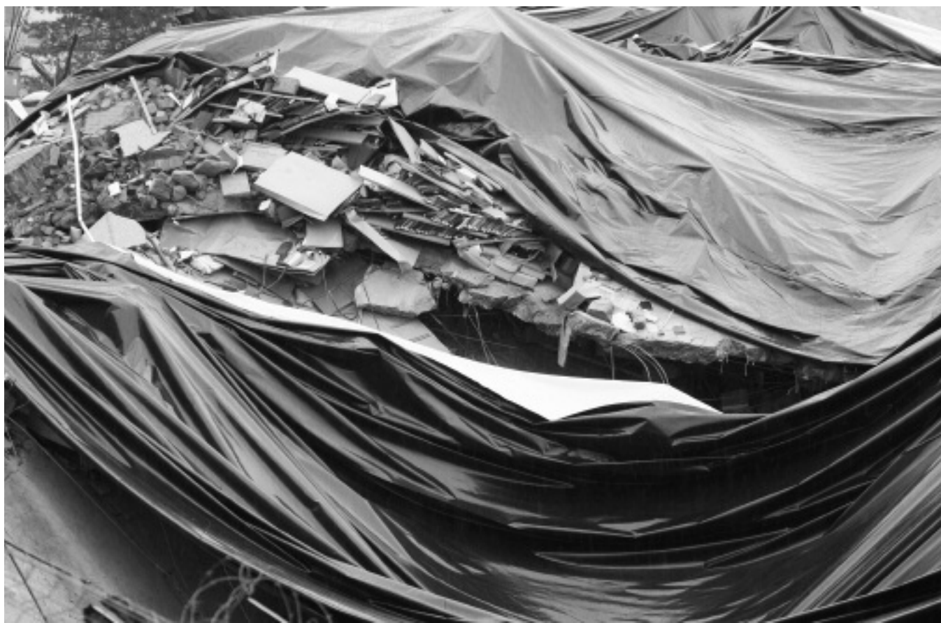
Der Trümmerberg im Süden der Einsturzstelle mit Folienabdeckung gegen den Regen (Foto: Jürgen Schütze/Berufsfeuerwehr Köln)
