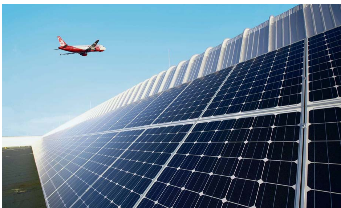
Solarmodule wandeln Sonnenstrahlen in elektrische Energie um. Das Bild zeigt die auf dem Dach der Flugzeughalle 7 befindliche Photovoltaikanlage.
