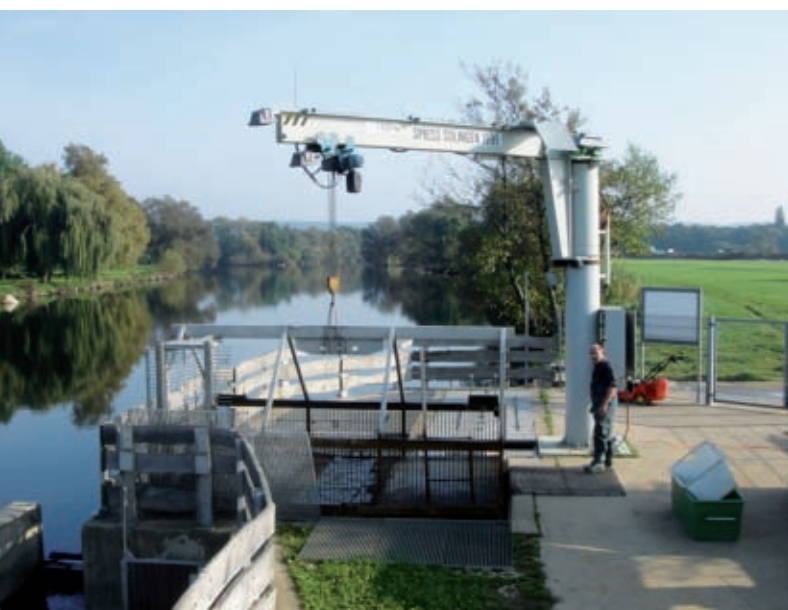
Kontrollstation Buisdorf an der Sieg
