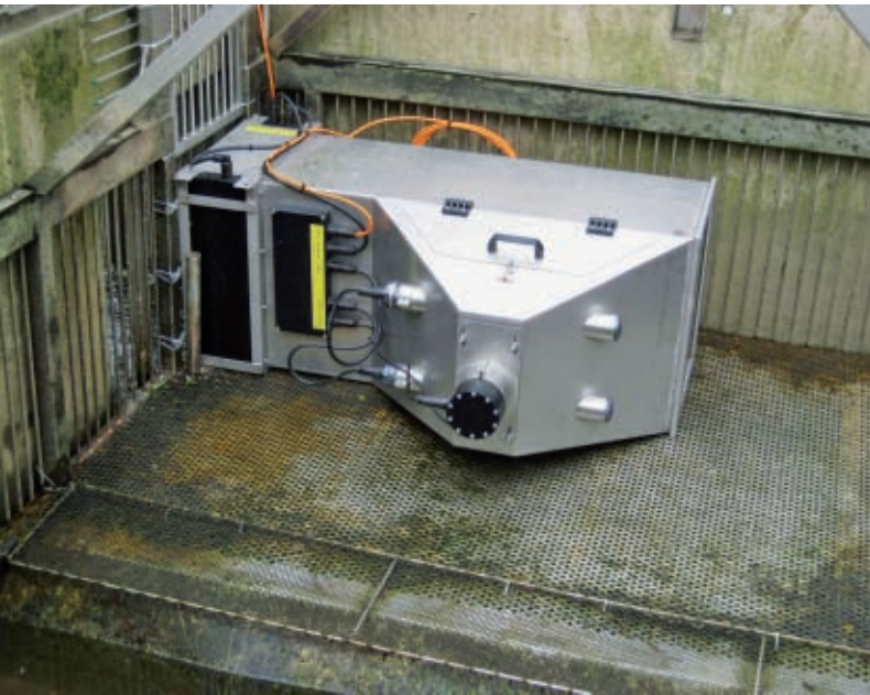
Automatisches Fischzählssystem „river watcher“ an der Kontrollstation Buisdorf Foto: Stiftung Wasserlauf
