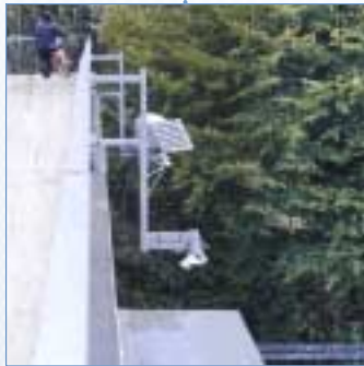
Infrarotmesseinrichtung an einer Brücke
