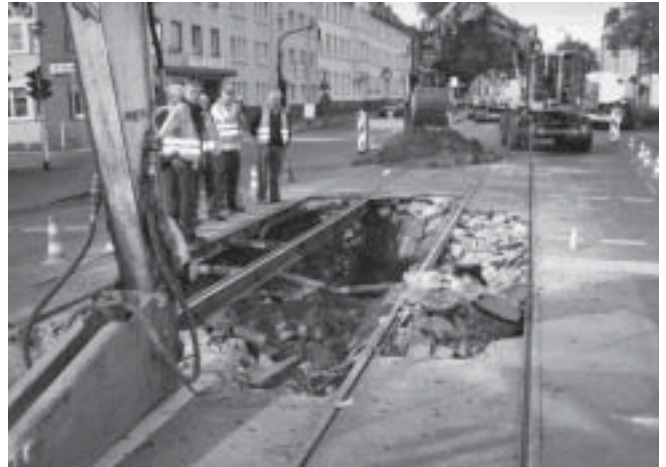
Die Hülser Straße ist zwischen Girmesgath und Weyerhofstraße voll für den Verkehr gesperrt. Grund sind große Löcher unter dem Asphalt, die bei Probebohrungen entdeckt wurden.
