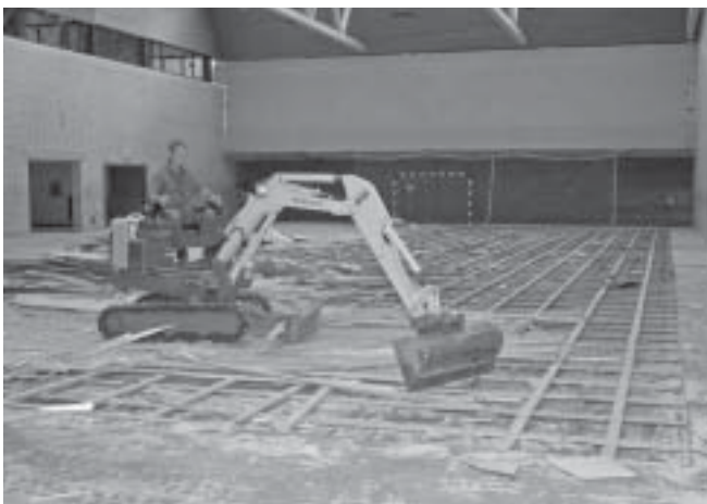
Der Boden der Glockenspitzhalle, der vom Unwetter Anfang Juli beschädigt wurde, wird herausgerissen und erneuert.
