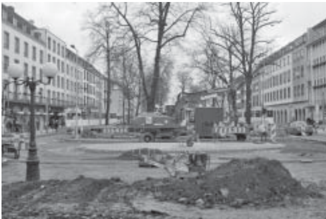
Wegen der Bauarbeiten auf dem Ostwall müssen am Sonntag, 19. April, der Bus- und Schienenverkehr in Richtung Bahnhof über die Philadelphiastraße geleitet werden.
