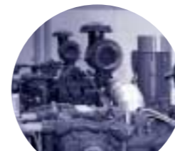
Hochwasserpumpwerk Kläranlage Süd
