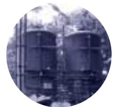
Grundwassersanierungsanlage im Südpark
