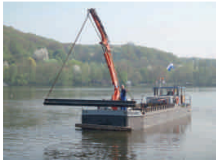
Bild 10.11: Doppel-T-Träger auf dem Weg zum Einsatz im Baldeneysee am 28. April 2009 Fig. 10.11: Double T-bar before being used in Lake Baldeney on April 28, 2009
