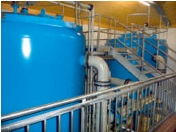
Bild 20.3: Die Aktivkohlefilter werden nach der UF-Anlage in Reihe betrieben
