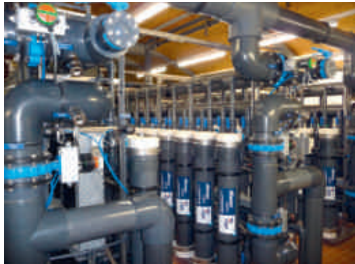
Bild 20.1: Ultrafiltrationsmembran(UF)-Anlage im Wasserwerk Mengesohl Fig. 20.1: Ultra membrane filtration plant (UF) at the waterworks Mengesohl
