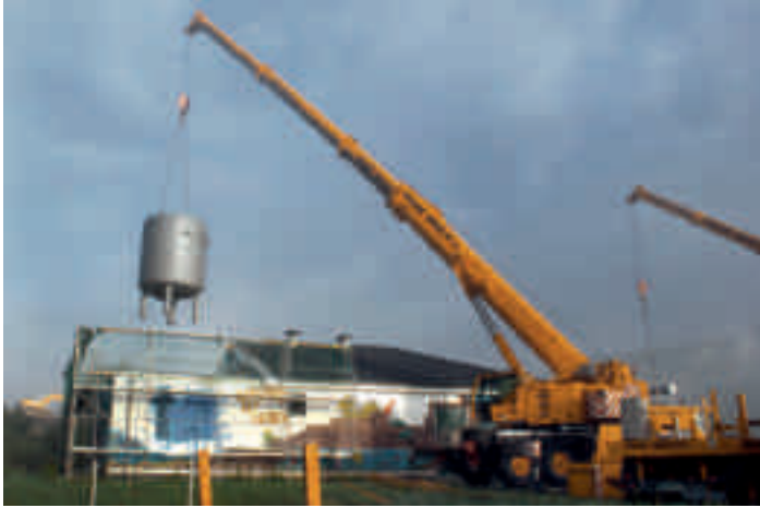
Bild 20.2: Installation zweier geschlossener Filterkessel für Kornaktivkohle im Wasserwerk Mengesohl im Jahr 2009
