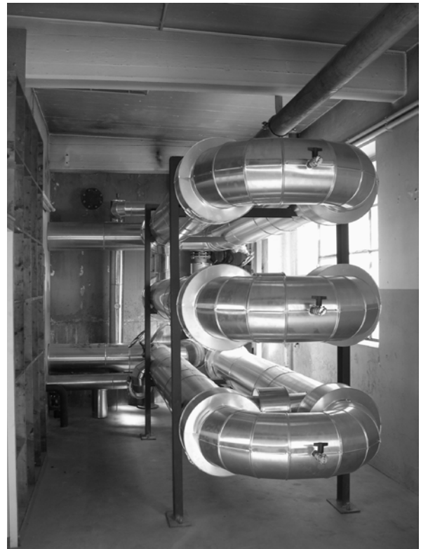
Neuer Wärmetauscher zur Schlammerwärmung
