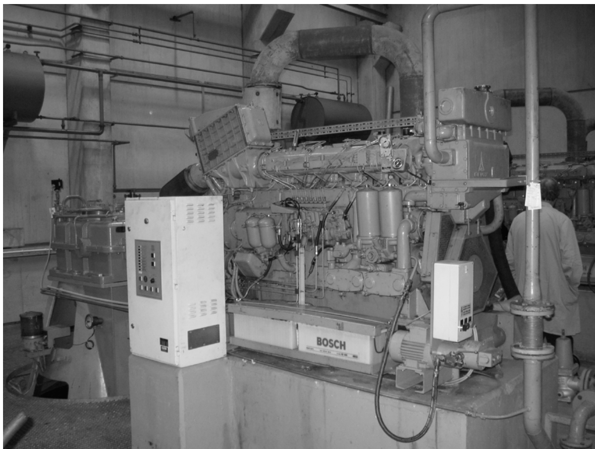
Dieselpumpaggregat auf der BST Rahser Bruch
