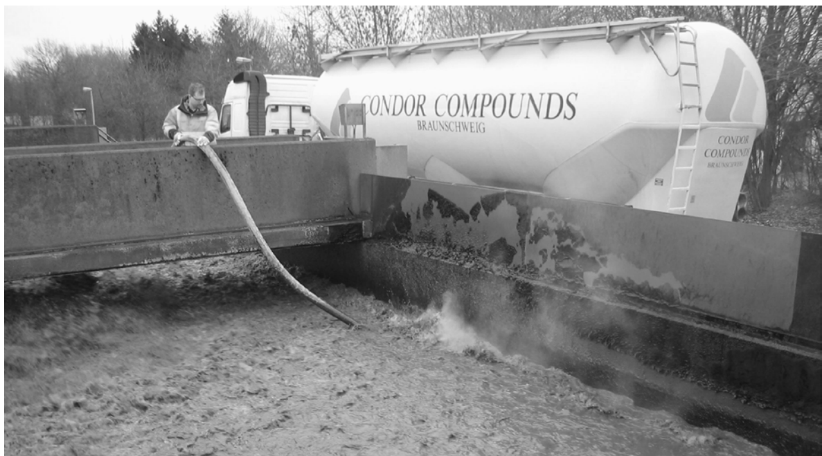
Dirk Roelofs dosiert Kreide in die Belebung des KW Goch zu
