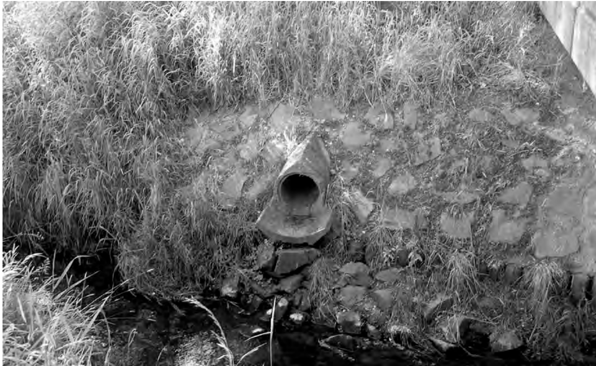
Einleitungsstelle für Niederschlagswasser in die Helmes Ley bei Kapellen
