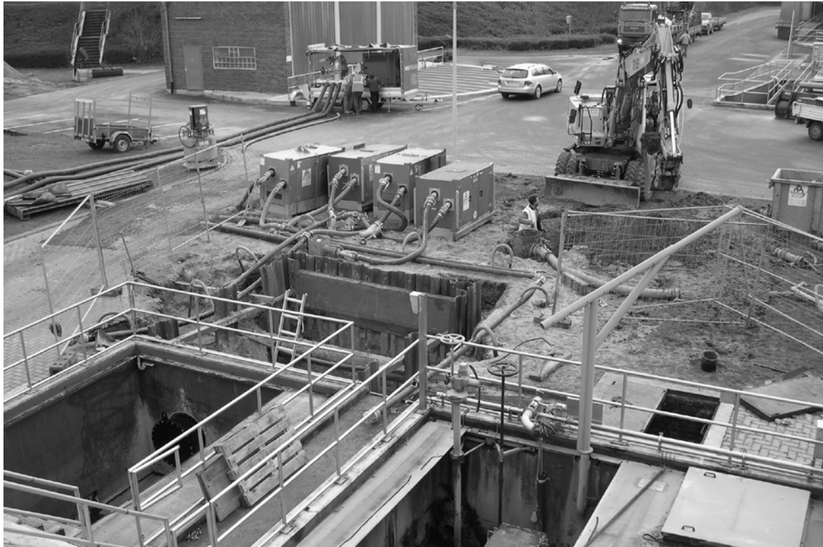
KW Grefrath: Umbau des Zulaufbereiches des Pumpwerkes inkl. der aufwendigen Grundwasserhaltung und der Überleitung des Abwassers in die biologische Stufe (hinten links)
