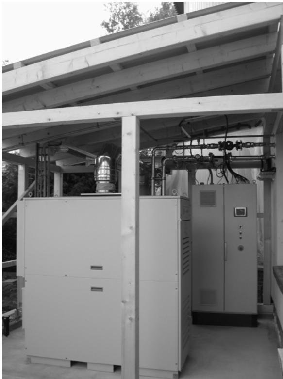
Mikrogasturbine mit Schaltschrank in der neuen Einhausung im Bauzustand
