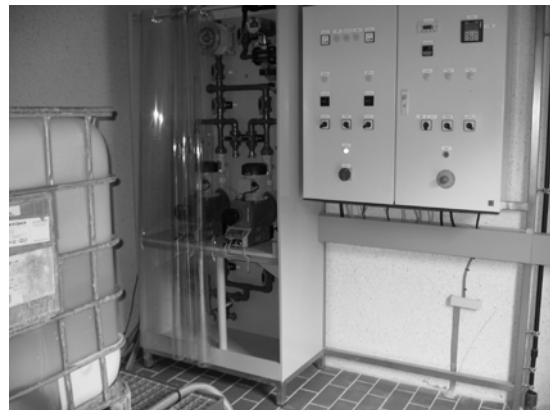
KA Herongen: Neu errichtete Neutralisationsanlage
