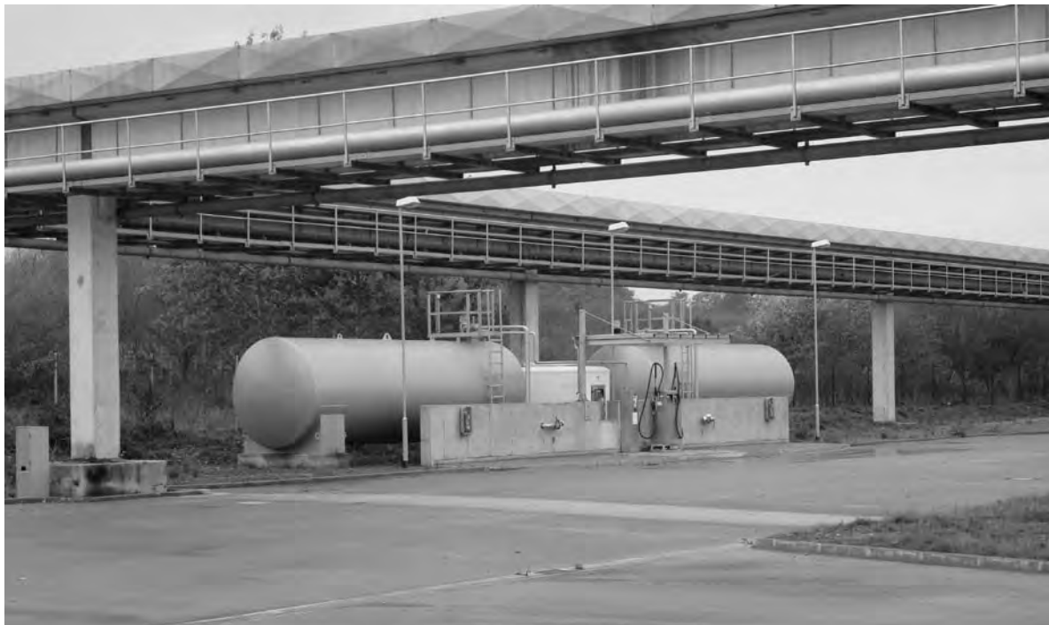
Klärwerk Mönchengladbach-Neuwerk: Eigenbedarfstankstelle
