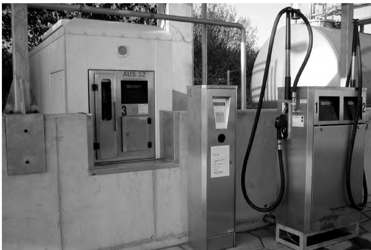
Neue AdBlue-Tankstelle auf dem Klärwerk Mönchengladbach-Neuwerk
