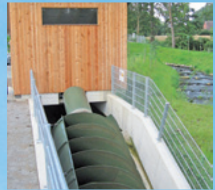
Wasserkraftschnecke an der Berkel
