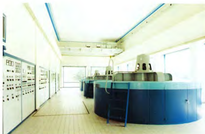
Generatoren im Biggekraftwerk
