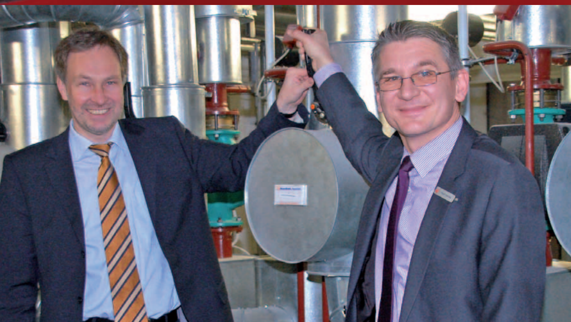
Start in ein neues Energiezeitalter, Inbetriebnahme des neuen BHKW durch die Projektinitiatoren: Prof. Dr. Thomas Hoffmann, Geschäftsführer der EWR und Frank Dehnke, Vorstandsvorsitzender der Sparkasse (v.l.n.r.)
