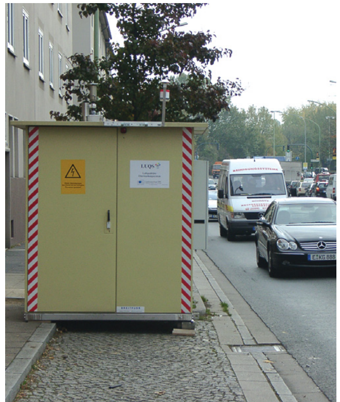
Abbildung 1.2-2: Container-Messstation in einer Straßenschlucht mit starker verkehrsbedingter Luftbelastung
