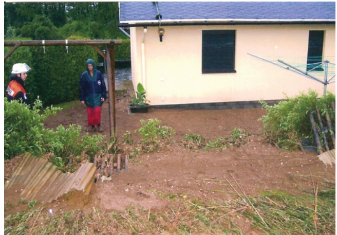
Abbildung 6.4-2: Schäden durch Bodenabschwemmung nach Starkregen (Quelle: Dirk Rauh)
