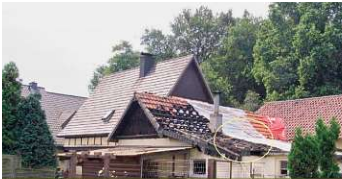
In diesem Fall ist es in einem Anbau zu einem Feuer mit Dachdurchbrand gekommen. Der Brandschwerpunkt war an der Holzkonstruktion des Daches nachvollziehbar, der Grund dafür zunächst nicht, zumal der Hauseigentümer von seinem Aussageverweigerungsrecht Gebrauch machte.
