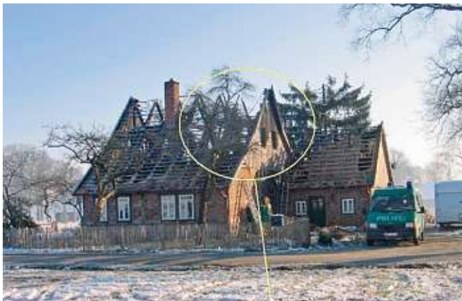
Brandstelle mit erkennbar größtem Zerstörungsgrad im rechten Dachbereich des Haupthauses!
