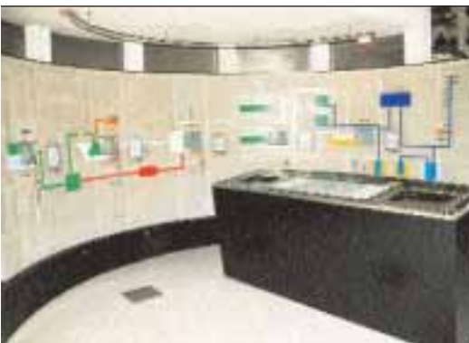
Im Leitstand wird die Arbeitsweise eines Wasserwerks erläutert.
