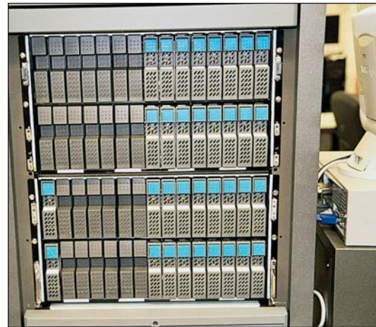
In der neuen Speichereinheit mit 32 Terrabyte drehen sich die Platten 15 000-mal pro Minute.
