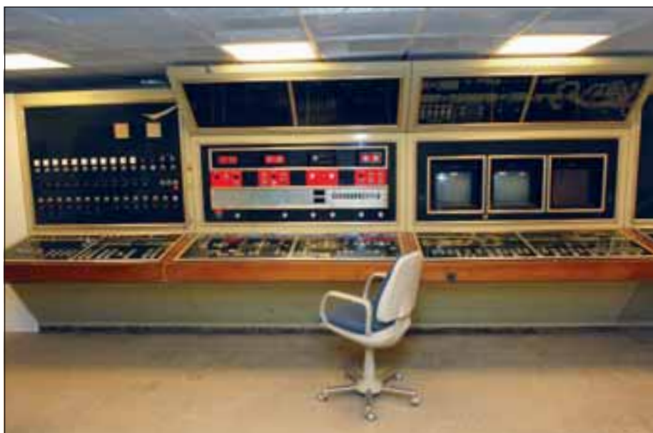
Der rekonstruierte Kontrollraum für die technischen Einrichtungen ist das Herzstück des Museums-traktes.
