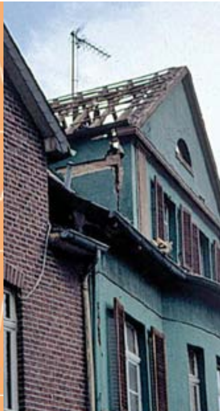
Erdbebenschäden an Häusern in Heinsberg
