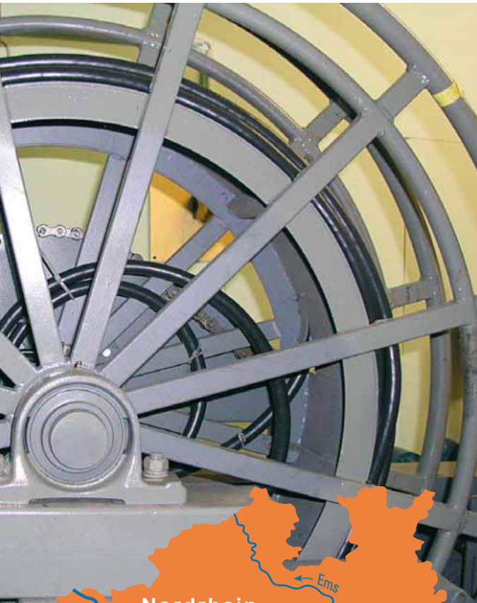
Kabelwinde an einer Bohrlochstation
