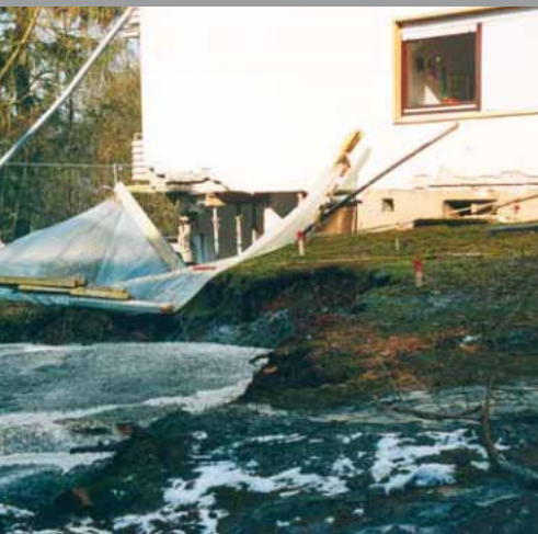
Die geologischen Kenntnisse über den Untergrund halfen bei der Sanierung der Siegener Altbergbau-Tagesbrüche.
