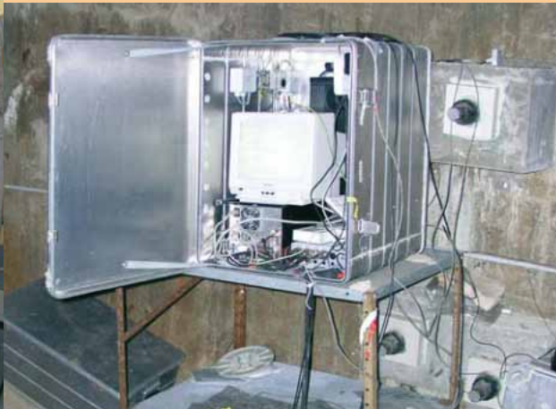
Container mit Registriergeräten an einer Seismikstation
