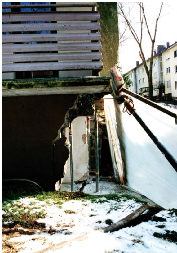
Einsturzgefahr! Hausecke und Kellerbereich dieses Wohnhauses sind in einem Tagesbruch versunken.
