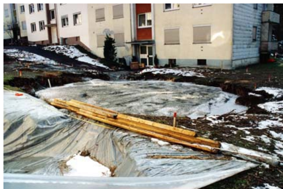
Mit Beton verfüllte Einsturzkrater zweier Tagesbrüche, wobei der vordere mit Planen abgedeckt ist.
