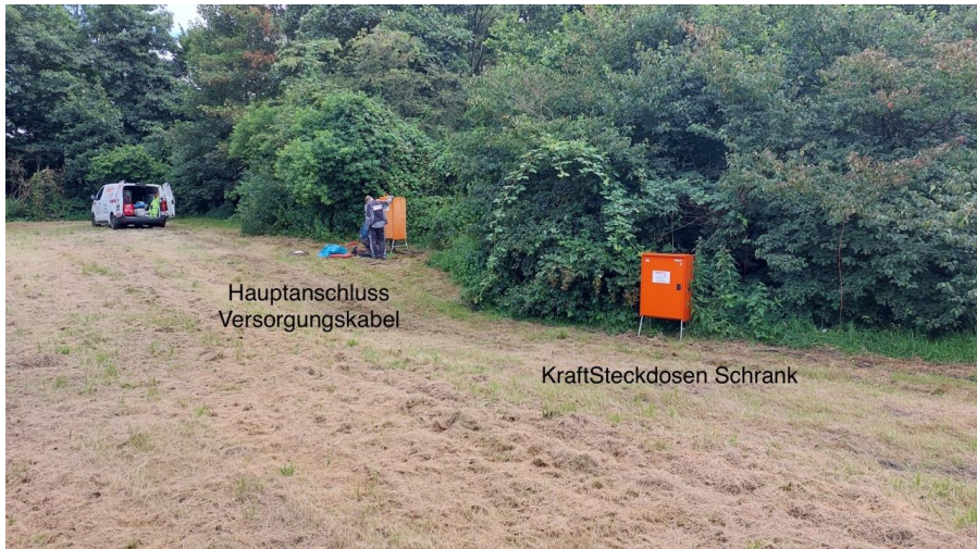
Temporärer Baustromverteiler zum Burgspektakel 2024
