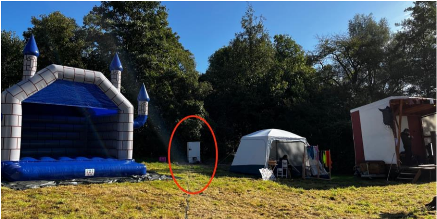
Der endgültige Stromversorgungsschrank bei den Highland Games 2024
