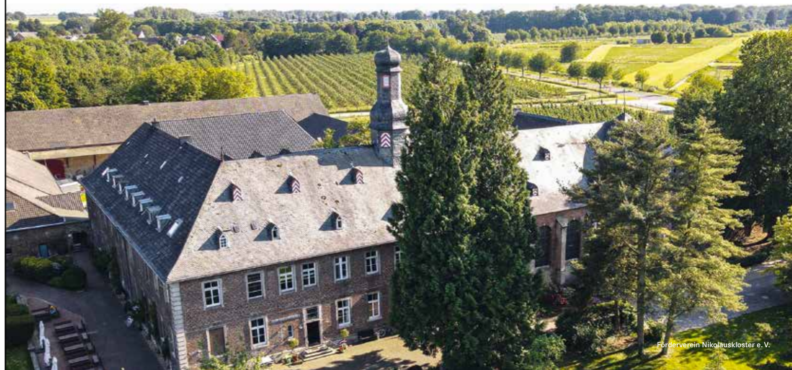
Blick auf die historischen Gebäude des Nikolausklosters. Die Dachflächen bedürfen einer umfassenden Sanierung, damit die „Oase im Rhein-Kreis Neuss“ weiterarbeiten kann.
