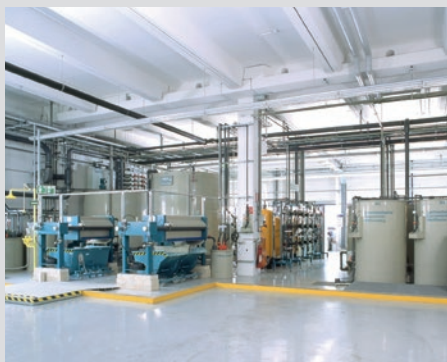
Anlage zur Abwasserbehandlung von aqua plus
