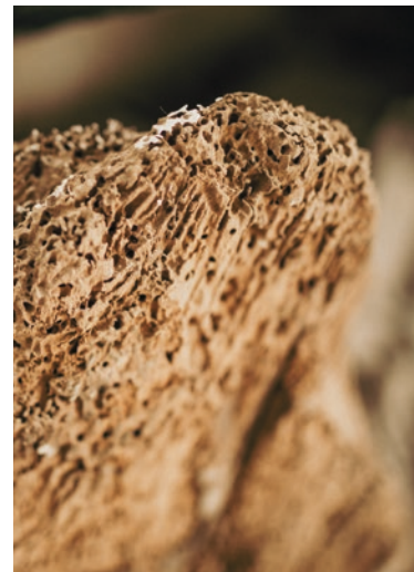
Der Sanierungsbedarf war gewaltig: Großteile der Holzbalken waren von Schädlingen befallen und zerfressen.
