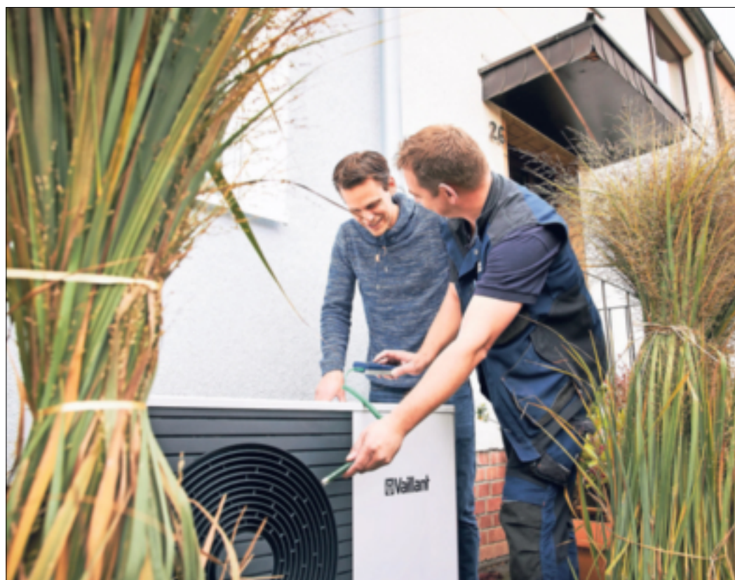
Bis zu 70 Prozent Zuschuss vom Staat gibt es für den Einbau moderner, umweltfreundlicher Heiztechnik. Foto: djd/Vaillant/Joachim Stretz
