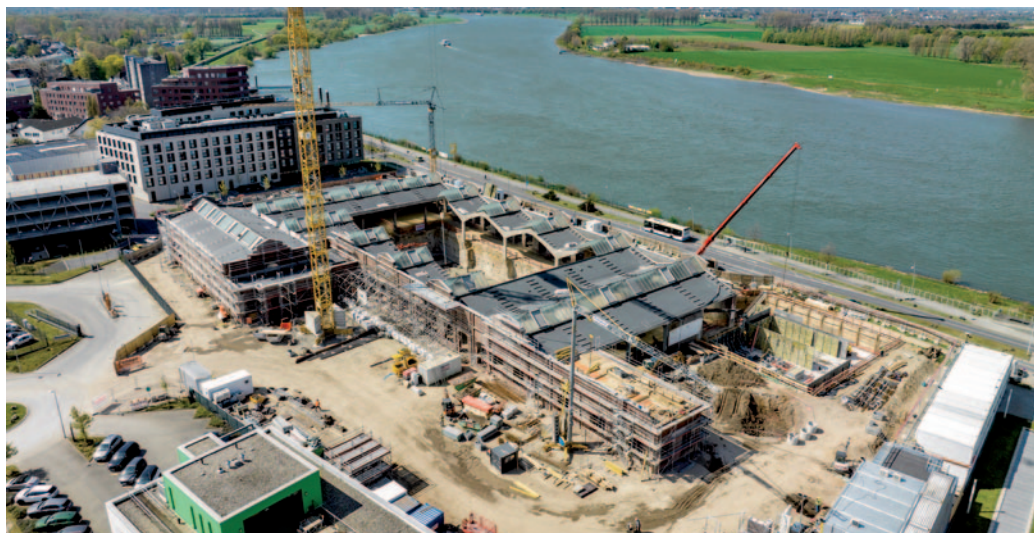
Beste Aussichten für das heimische Kulturangebot! Die wichtigsten Vorarbeiten sind erledigt, der erfolgreiche Dachausschnitt für den spektakulären Kubus inmitten des historischen Bestandsgebäudes ist auch auf diesem Foto gut zu erkennen. Jetzt wird der Grundstein zur neuen Kulturraffinerie K714 gesetzt.
