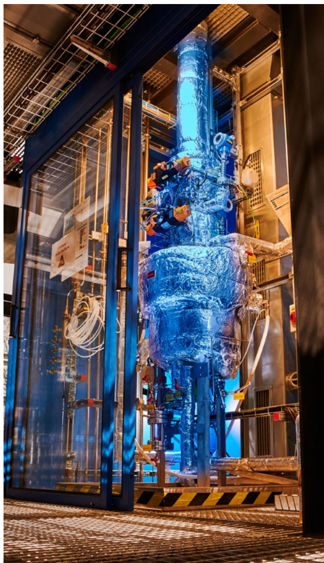
Die Pilotanlage von Evonik in Hanau für das Recycling von Polyurethan-Matratzen.
