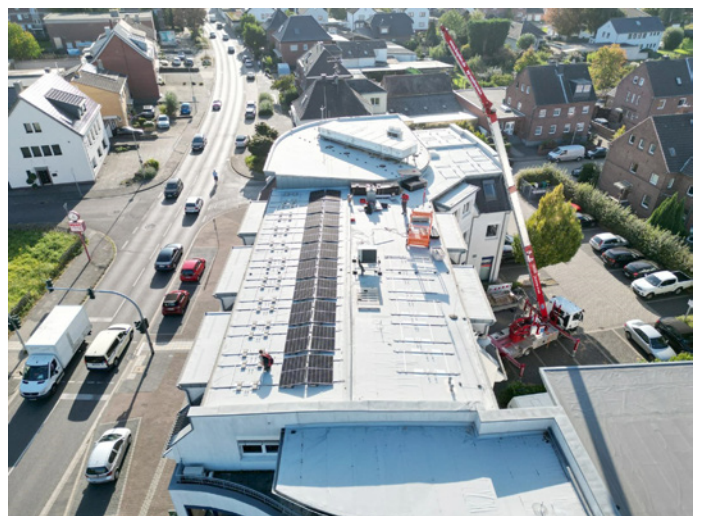
Zum Jahresende folgte die Solaranlage auf dem Dach des Dienstleistungszentrums an der Bahnstraße.
