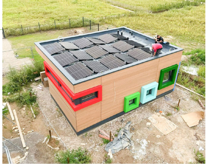
Verbaut wurden in Widdeshoven 18 Solar-Module mit einer Höchstleistung von 7,47 Kilowatt-Peak (kWp). Fotos: SMEu.
