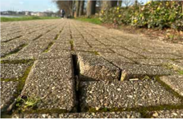
Die Baumwurzeln haben schon die ersten Pflastersteine herausgedrückt und zu Stolperfallen verwandelt Fotos: Gerhard Altenhofen
