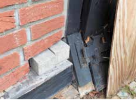
Extreme Beschädigung nach dem Unfall Foto: Richy Beesch
