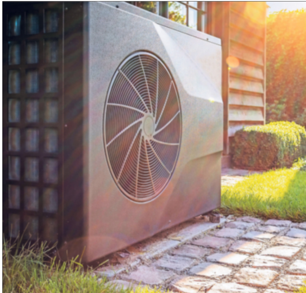
Moderne Luft-Wasser-Wärmepumpen nutzen die Wärmequelle Luft so effizient, dass sie auch in älteren Wohnhäusern eingesetzt werden können.
