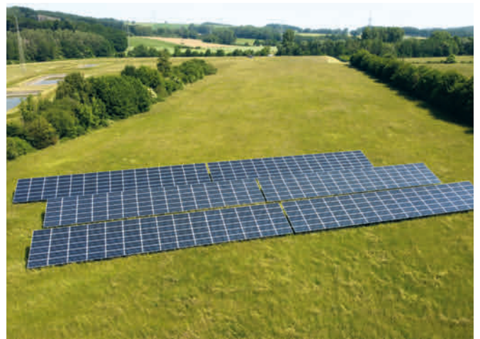
Bild 20.1: Freiflächen-Photovoltaikanlage Möhnebogen Fig. 20.1: Open-space photovoltaic system Möhnebogen
