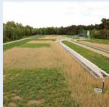
Retentionsbodenfilter NATO Air Base Geilenkirchen-Teveren
