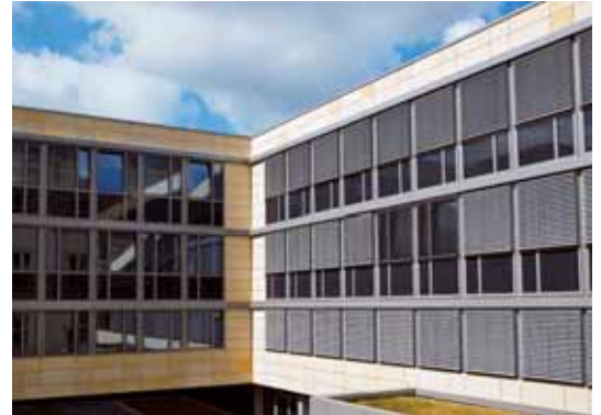
Die Fassade des Neubaus ist bereits saniert und passt nun farblich viel besser zum Altbau (Bild u.).
