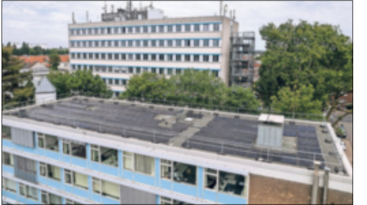
Wie der neue Energiebericht zeigt, ist die Kreisverwaltung auf einem guten Weg in Sachen Klimaschutz und Energieeffizienz – hier die Photovoltaikanlage auf dem Gesundheitsamt. Foto: A. Baum/RKN
