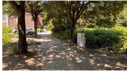
Der neue Abzweig- und Verteilerschrank für die Versorgung der „Ostwiese“
