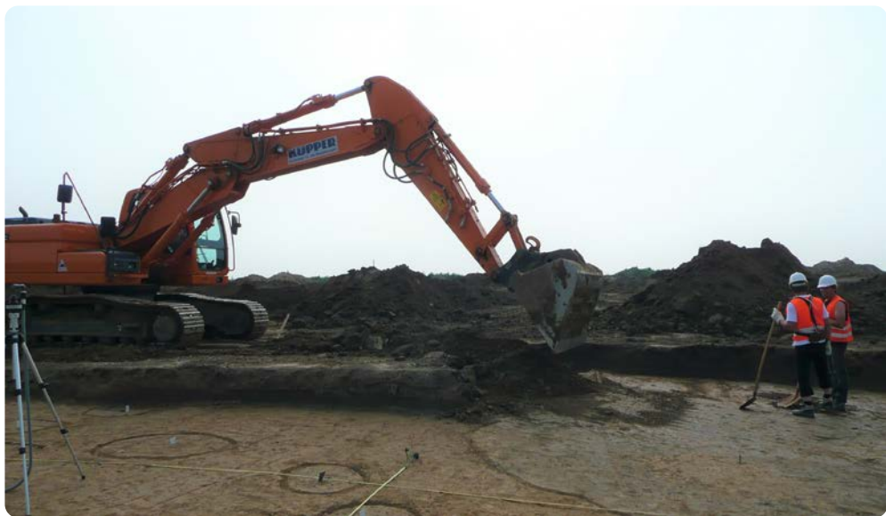
Abb. 57: Gefahrenbereich von Baggern, Foto: A. Krieger
