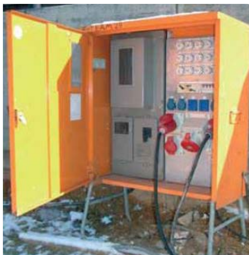
Abb. 66: Fehlerstromschutzschalter im Baustromverteiler, Foto: W. Dohmen
