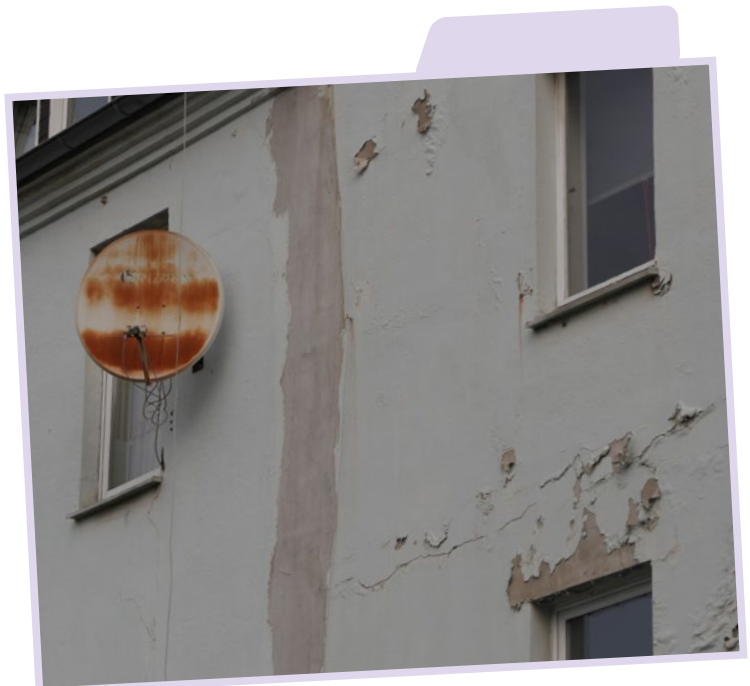
Teil der Fassade einer Problemimmobilie in Gelsenkirchen
