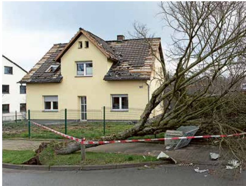
Ein vom Orkantief ZEYNEP aus der Erde herausgerissener Baum hat einen Stromkasten im westfälischen Bielefeld zerdeppert – und auch das Dach dieses Wohnhauses ist arg in Mitleidenschaft gezogen worden. (Quelle: picture alliance/dpa/Friso Gentsch)
