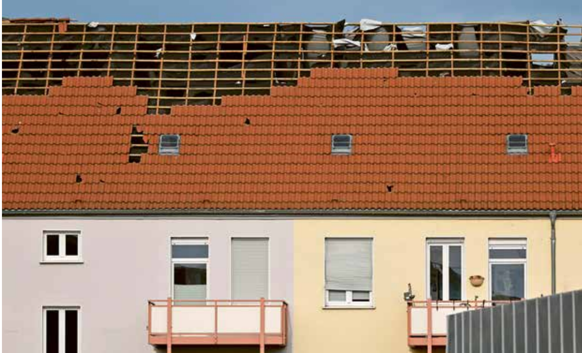
Auch dieses Gebäudedach im nordrhein-westfälischen Paderborn wurde in großen Teilen abgedeckt. (Quelle: picture alliance/Panama Pictures/Christoph Hardt)
