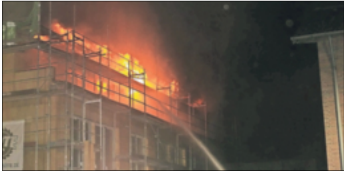
Der hölzerne Rohbau ist aus bisher ungeklärten Gründen in Vollbrand geraten. Foto: Polizei
