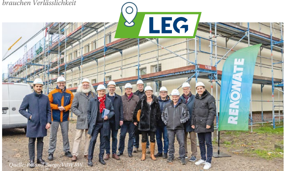
Serielles Sanieren in Mönchengladbach – LEG und RENOWATE machten es im ersten Pilotprojekt möglich
