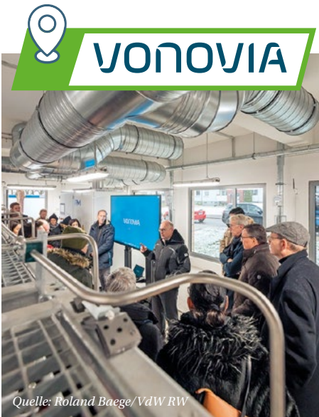
In Vonovias Energiezentrale der Zukunft werden 81 Wohnungen mit grünen und dezentralen Energiequellen beheizt
