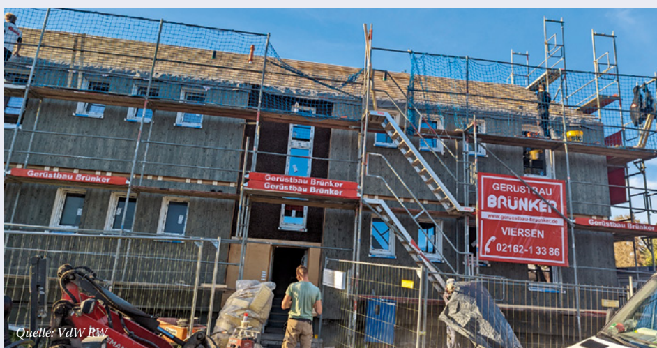
Quelle: VdW RW Serielle Sanieren – die beste Methode für schnelle energetische Modernisierungen?
