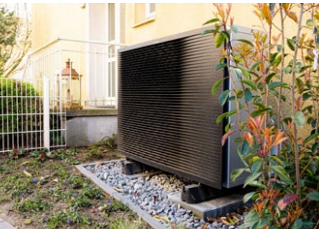
Wärmepumpe an der Waterfohrstraße
