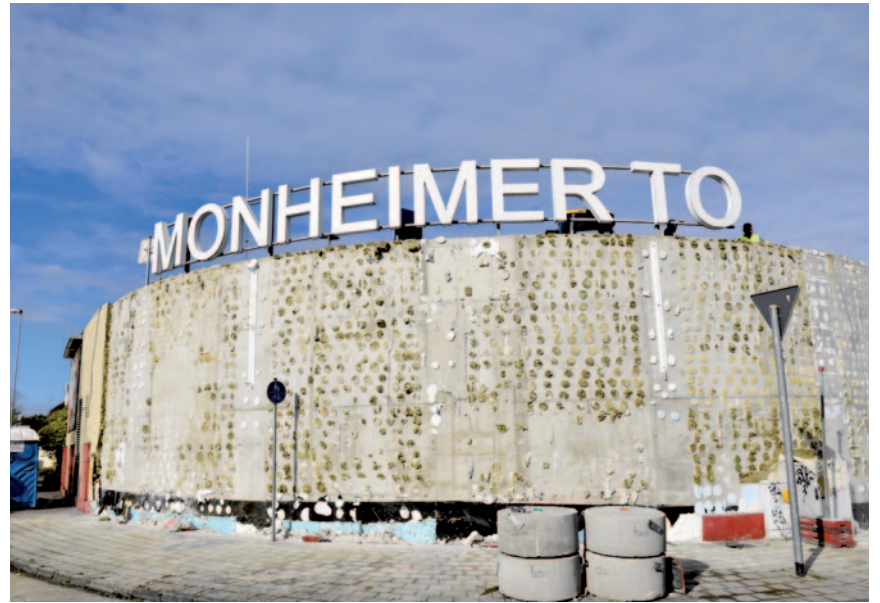
Sieht aus wie eine Kletterwand, ist dafür aber gänzlich ungeeignet. Von der Fassade des Monheimer Tors wurden im Ostteil die Zierblenden und Beleuchtungen entfernt.
