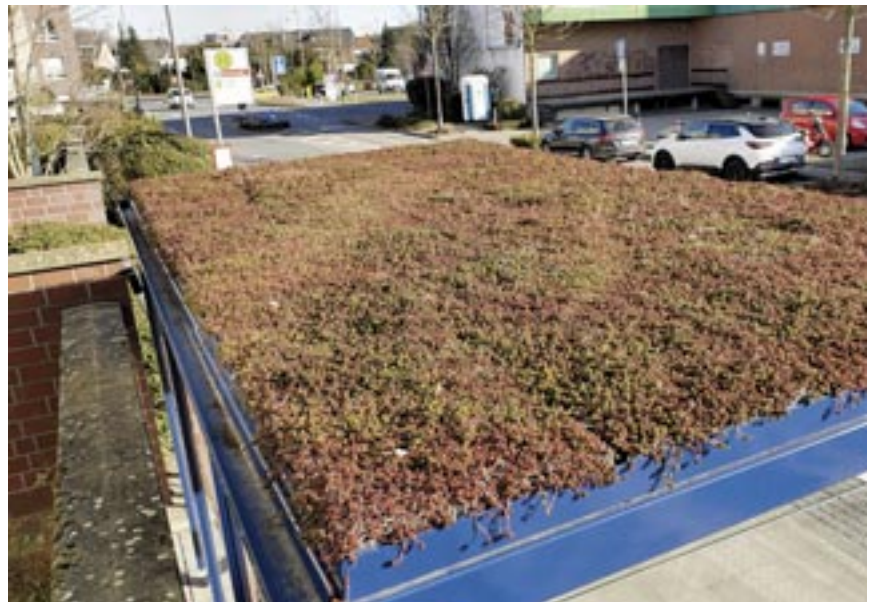
Foto: AWO Das Foto zeigt die Dachbegrünung der Bushaltestelle an der Turnerstraße.
